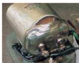
図 5.1.4 力率改善コンデンサケース破壊例 1)
